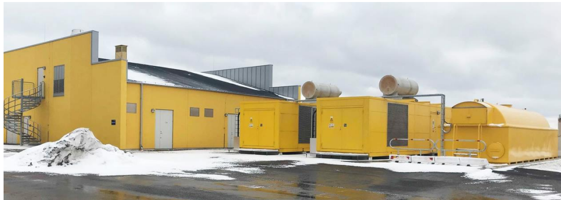
Figur 4.2 K50, ställverk med tillhörande generatorer och reservkraftscistern.
